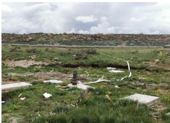
施工营地地理式生活污水处理设施
